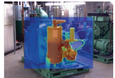
Industrie-Kompressor, Überblendung aus Wärme- und Sichtbild
